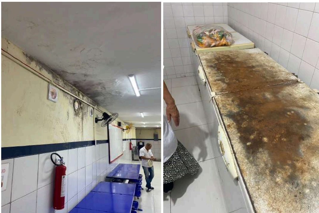
Figuras 116 e 117: Infiltração no teto (esq.) e freezers enferrujados (dir.)
