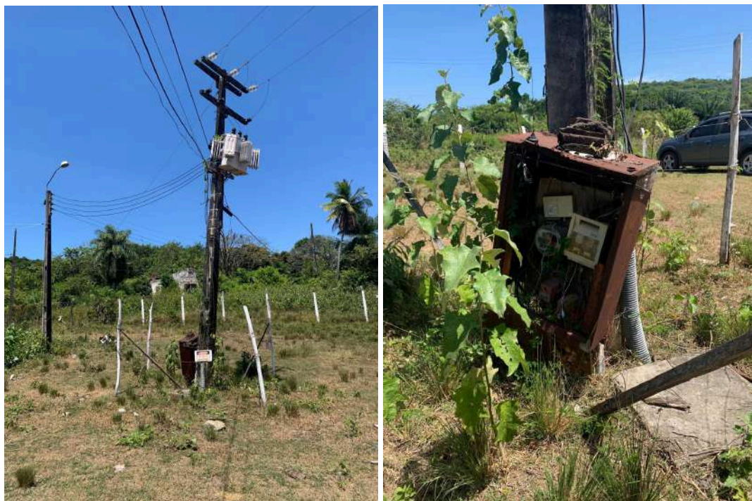
Figuras 103 e 104: Poste com transformador e quadro de energia
