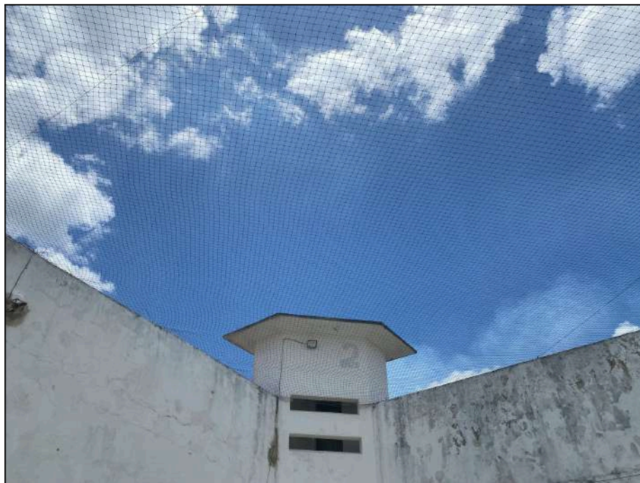
Figura 57: Telas de proteção
