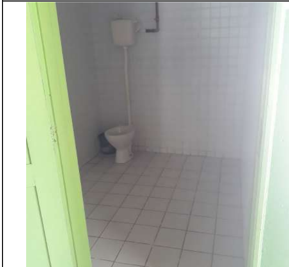
Foto 40: Vista de banheiro sem acessibilidade da E. M. Mundo Infantil.
