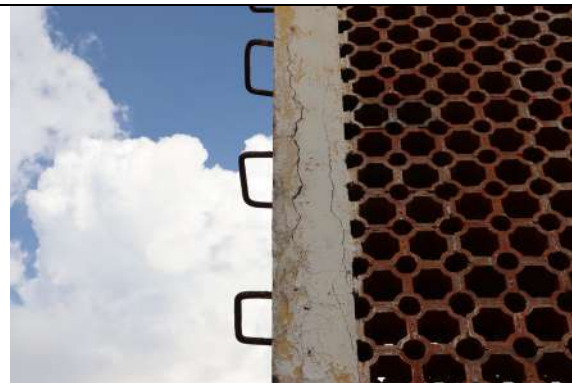
Fotos 47: Vistas das rachaduras nos pilares da caixa d'água elevada.
