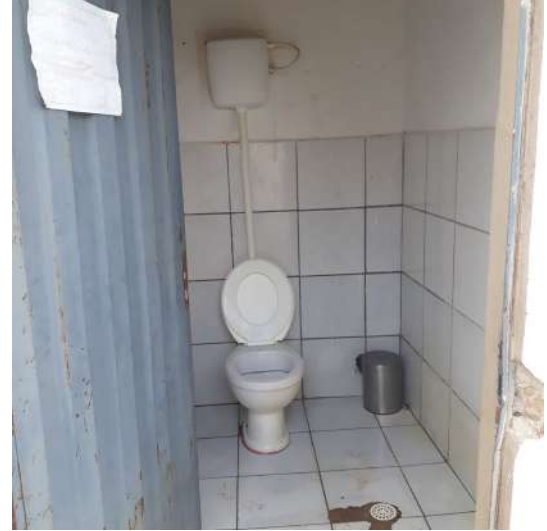
Foto 14: Vista interna de um dos banheiros dos professores do prédio antigo da E. M Dr. Nilo de S. Coelho.
