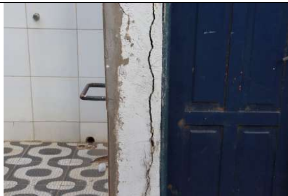
Fotos 46: Vistas das rachaduras nos pilares da caixa d'água elevada.
