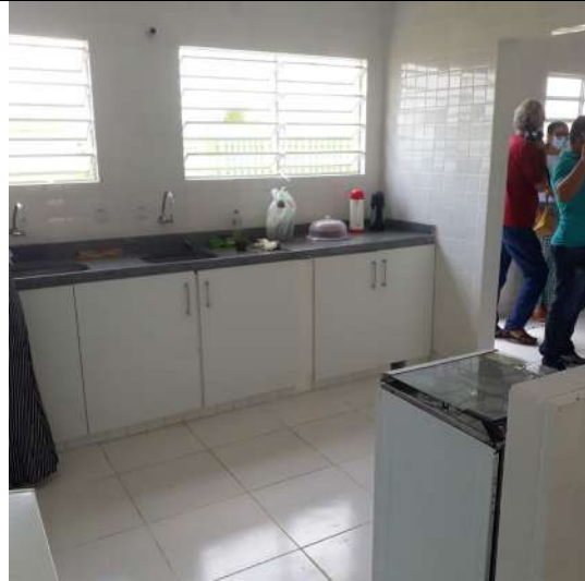
Foto 19: Vista interna da cozinha do prédio novo da E. M. Dr. Nilo de S. Coelho.
