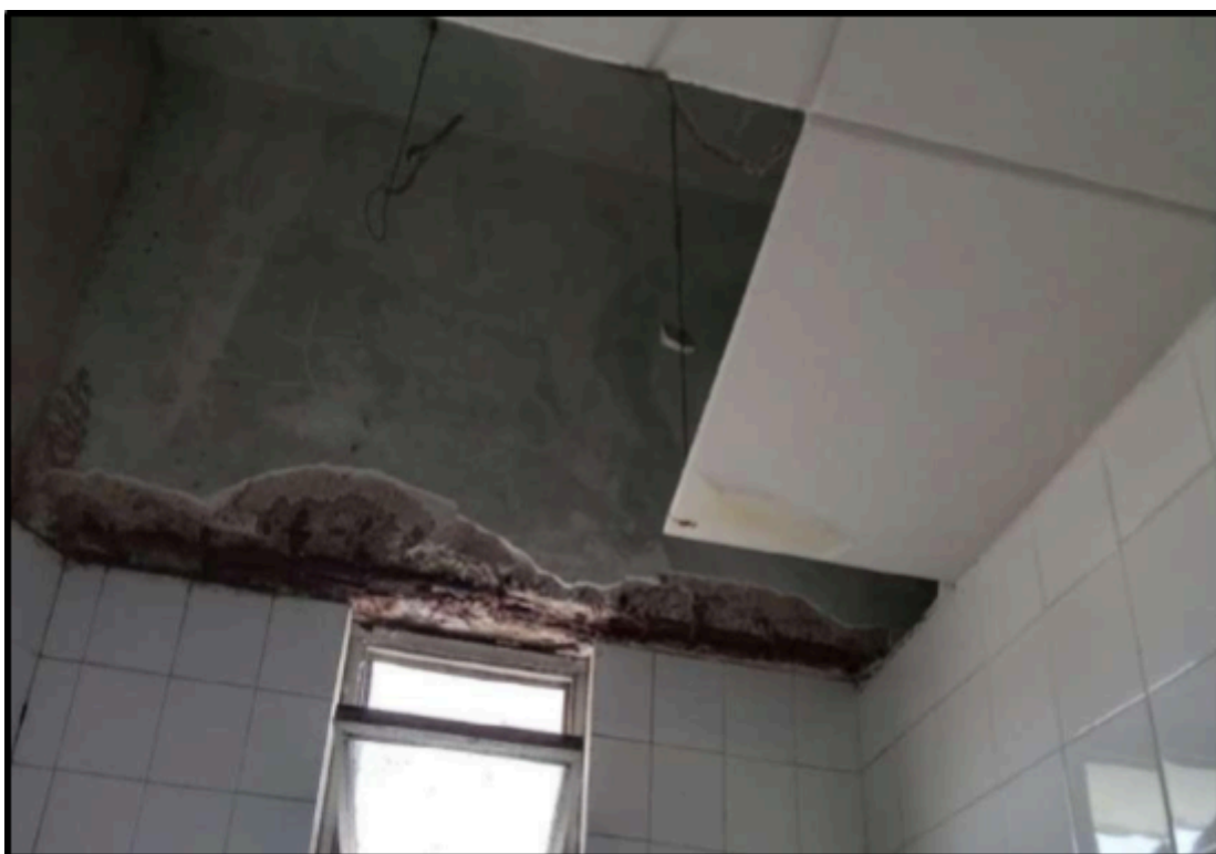
Figura 68: Teto do sanitário do alojamento do 16º BPM.
