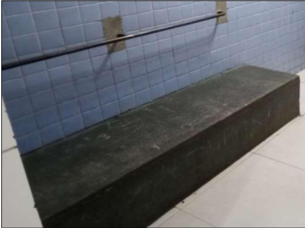
Figura 23: Suporte para algemar suspeito instalado na 213ª Delegacia Circunscrição
