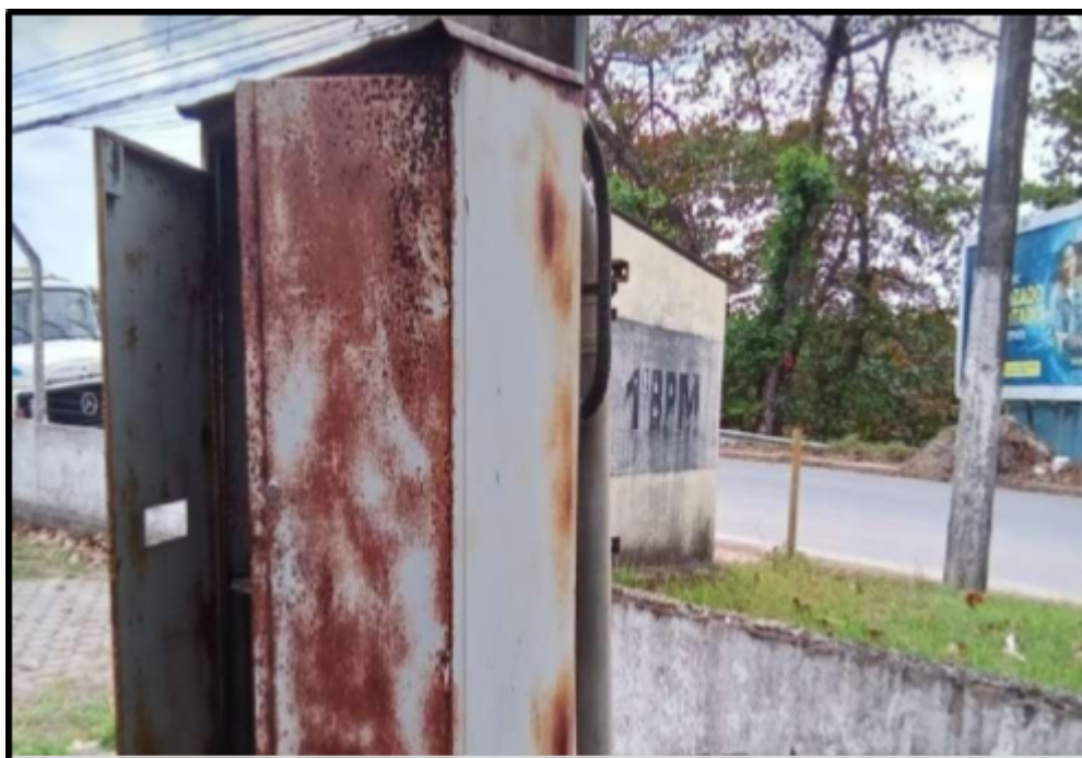
Figura 87: Imagem do medidor de energia do 1º BPM
