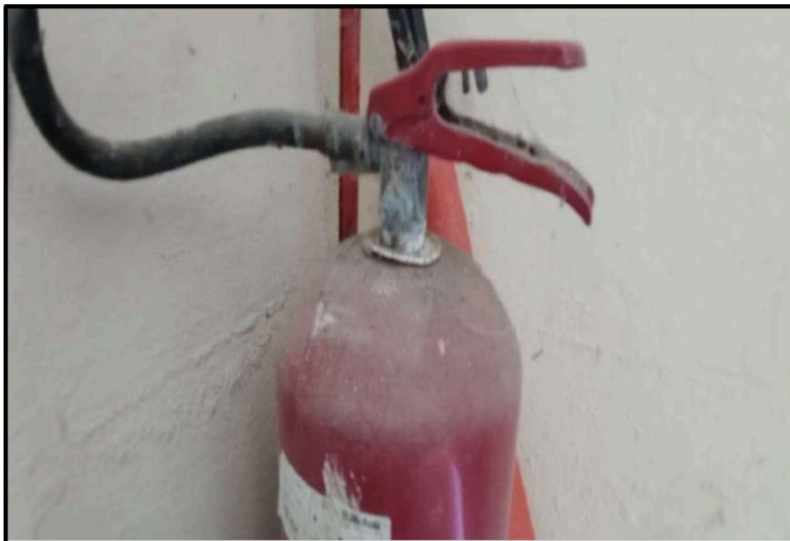
Figura 61: Extintor de incêndio da 2ª CIPM.
