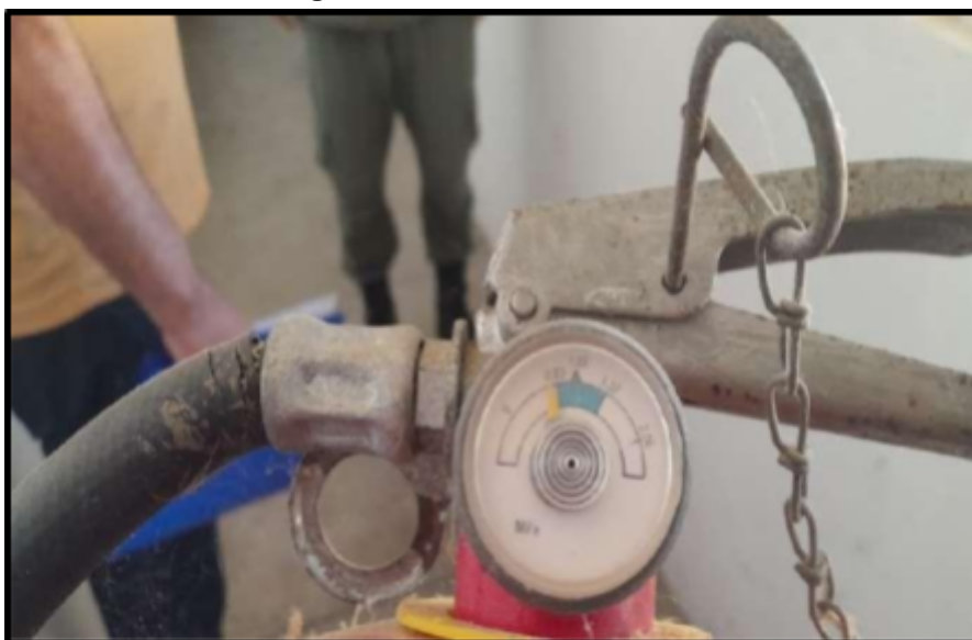
Figura 60: Extintor de incêndio da 1ª CIPM.
