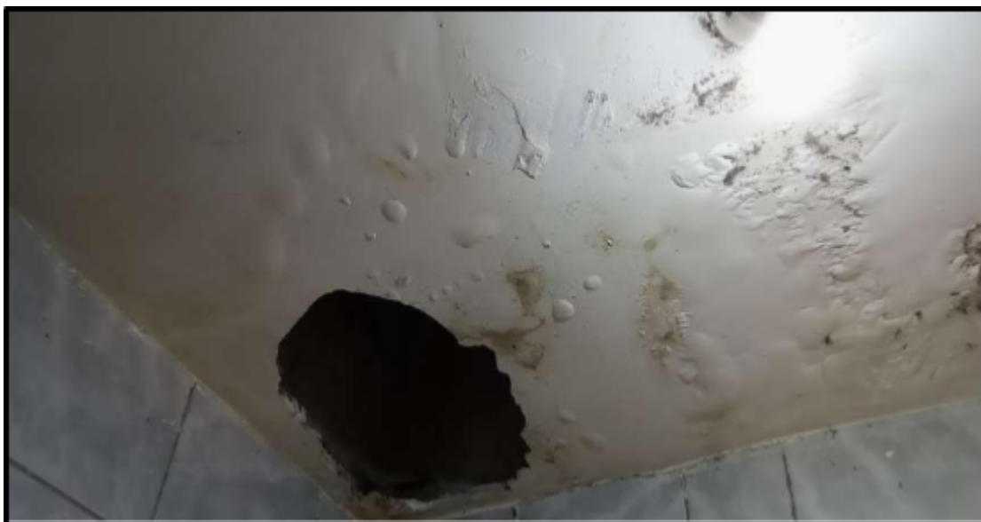
Figura 67: Teto do sanitário do alojamento do 9º CIPM.
