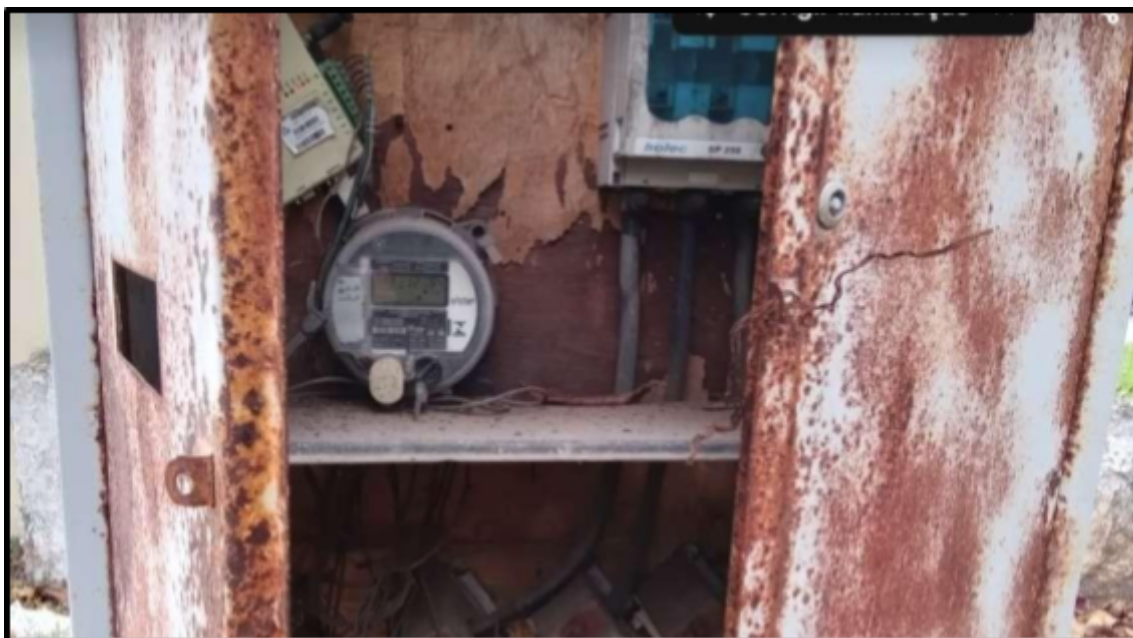
Figura 89: Imagem do medidor de energia do 1º BPM
