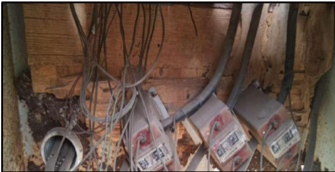
Figura 88: Imagem do medidor de energia do 1º BPM
