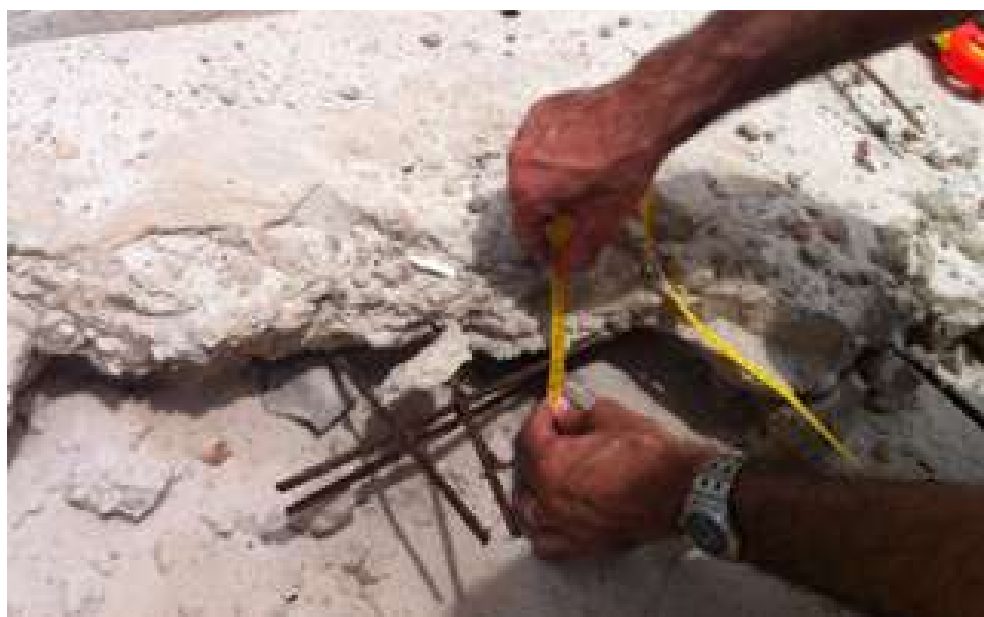
Figura 11. Concreto (mal adensado) e armação de laje executados diretamente sobre areia.
