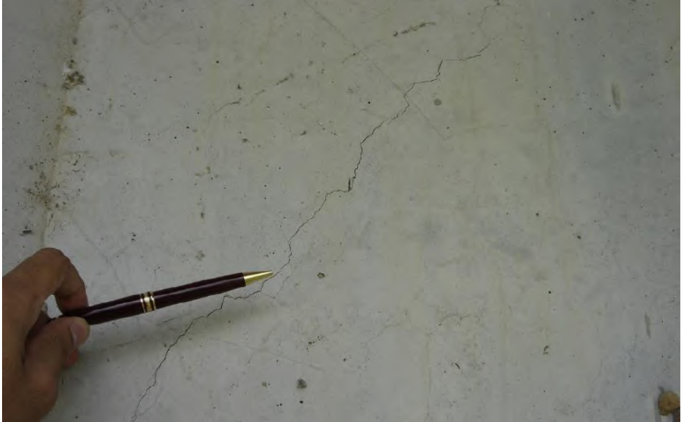
Figura 12. Rachaduras diagonais em vigas de concreto. Tais rachaduras, nas proximidades dos apoios, estão associadas à inaptidão para absorver esforços cortantes.
