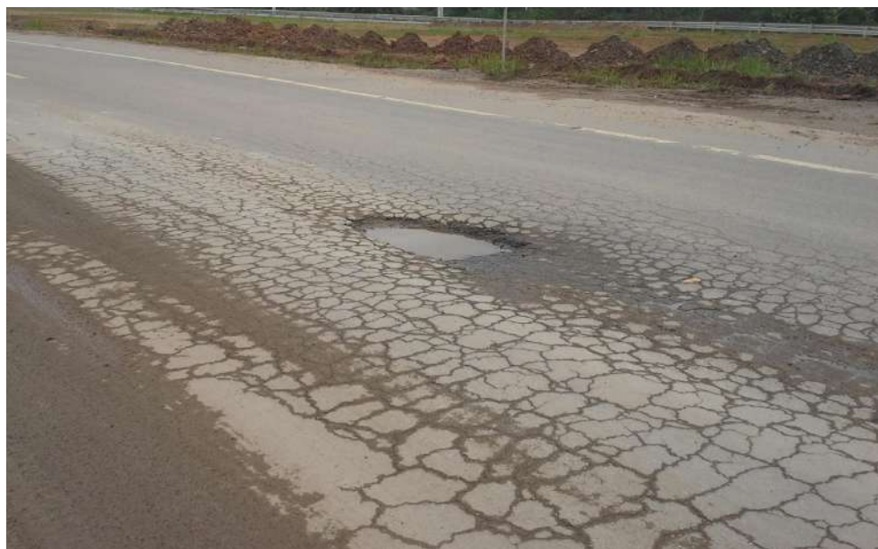
Figura 5. Trincas tipo jacaré e panela em rodovia asfáltica.
