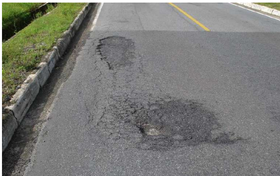
Figura 9. Trincamentos tipo couro de jacaré e deterioração generalizada.
