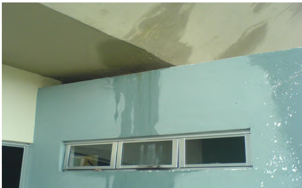
Figura 3. Vazamentos, provocando infiltrações, e descolamento da pintura.
