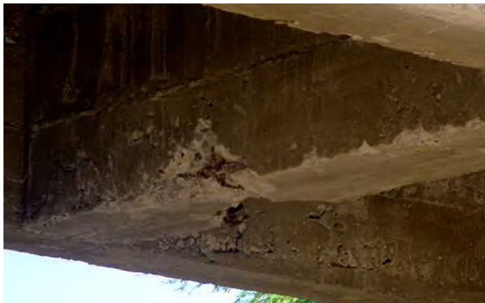
Figura 14. Seção de concreto com área reduzida e ferragem exposta na parte central da transversina; ao fundo, na longarina, pode-se observar a segregação dos agregados do concreto e a formação de nichos.
