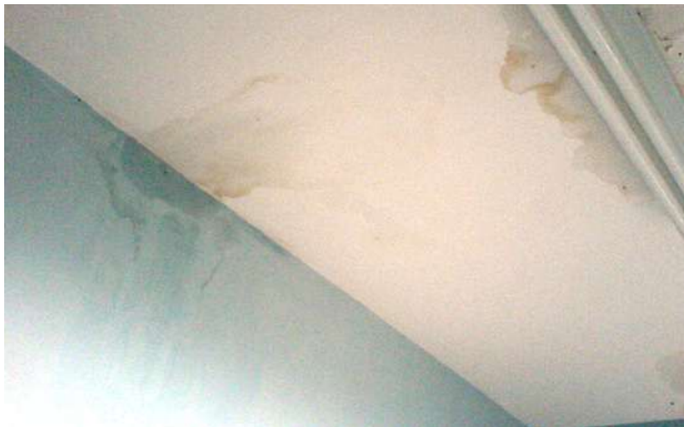
Figura 2. Infiltração em laje de cobertura: na junção com a parede e no local acima da luminária.
