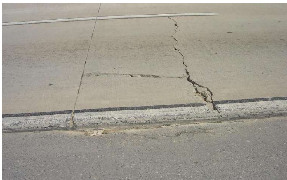
Figura 7. Rachaduras transversais típicas em placas de concreto.
