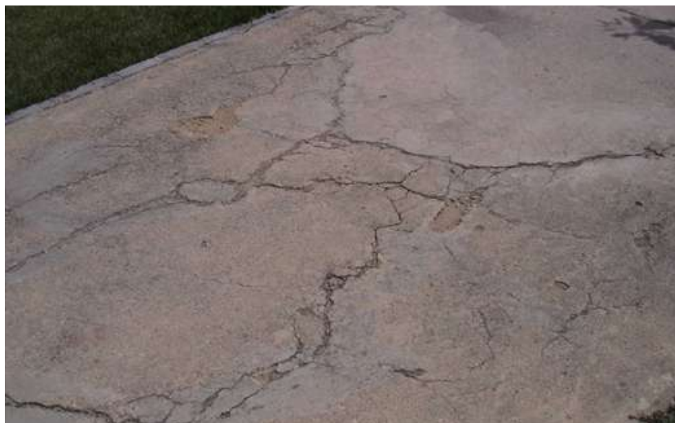
Figura 1. Rachaduras e desgaste precoce em passarela de concreto para pedestres.
