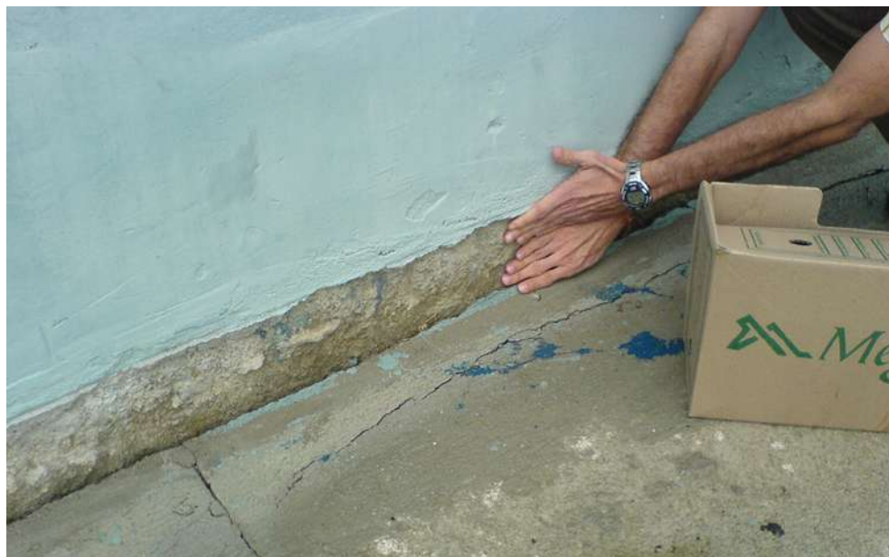
Figura 4. Afundamento da calçada de entorno da obra e rachaduras na calçada afundada.
