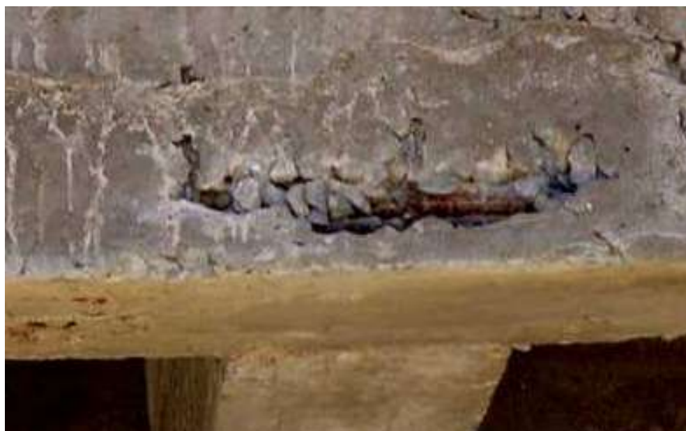
Figura 15. Péssimo acabamento, segregação de agregados e ferragem expostas.
