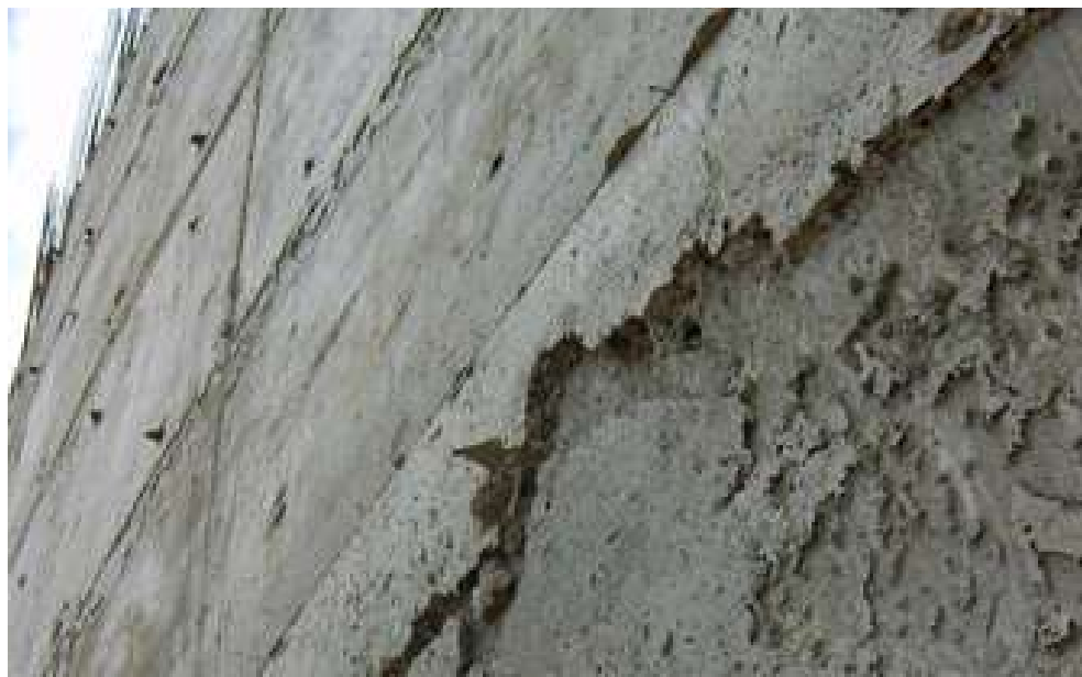
Figura 10. Estrutura de concreto com falhas na concretagem.
