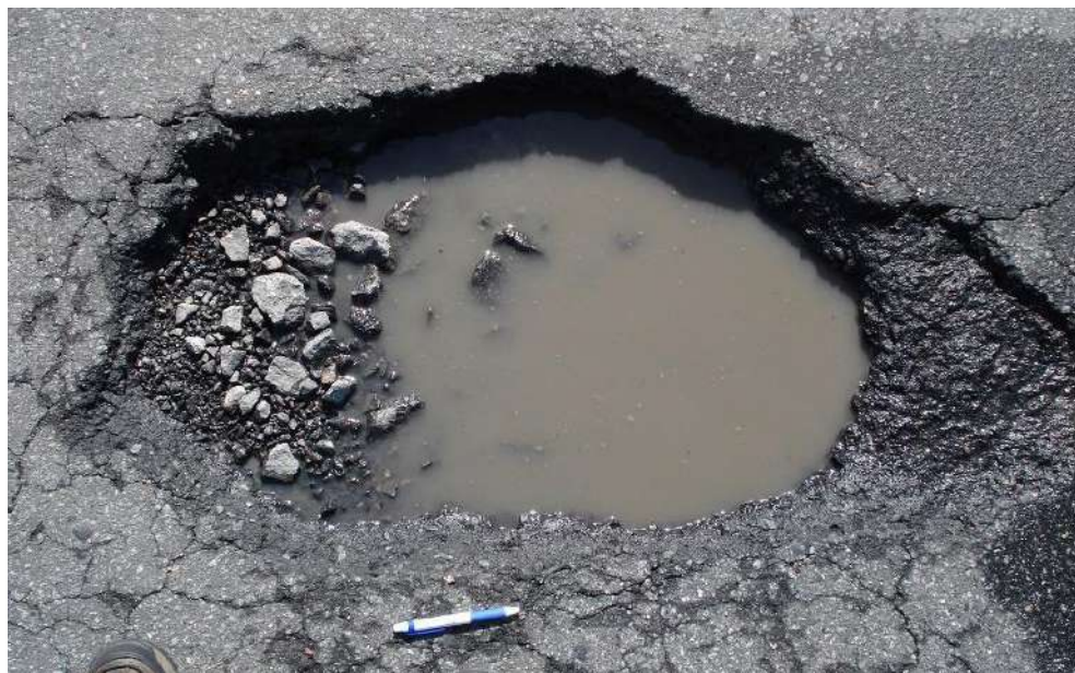
Figura 8. Panela e acúmulo de água.
