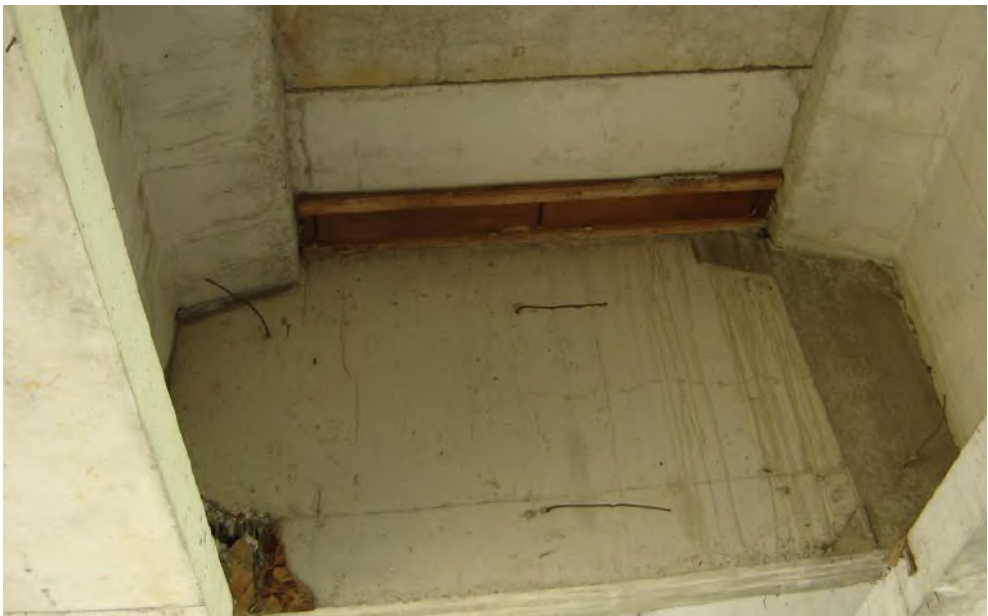
Figura 13. Restos de formas e de ferragens para a fixação das formas deixados nas estruturas concretadas.
