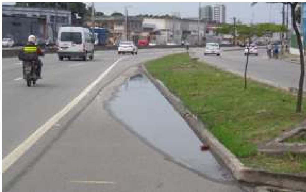
Figura 6. Acúmulo de água em acostamento.
